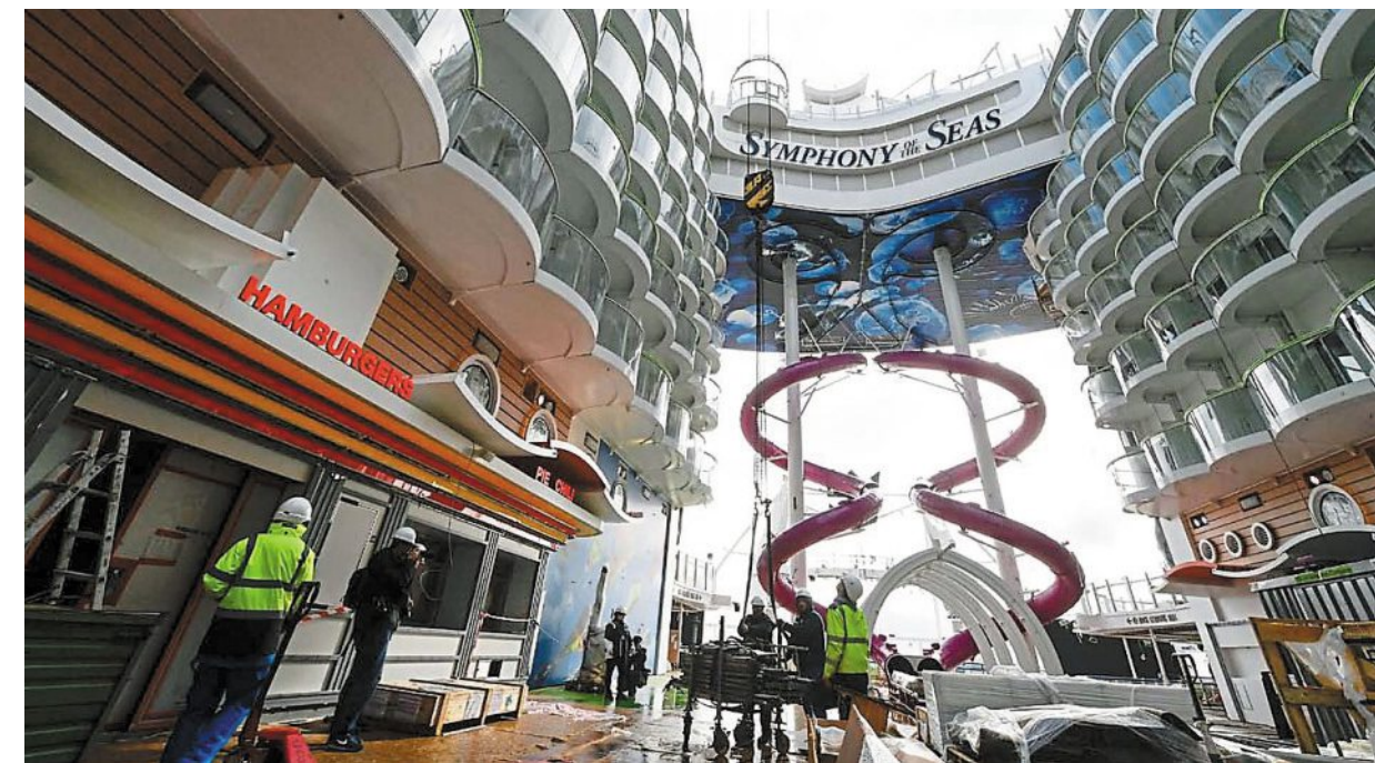
À bord du paquebot Symphony of the seas de Royal Caribbean, en construction aux chantiers navals STX de Saint-Nazaire.
